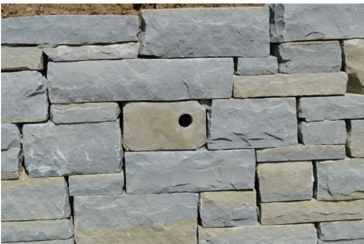
Abbildung 4: Wiedehopfnische in Trockensteinmauer (Foto: naturnetz).
